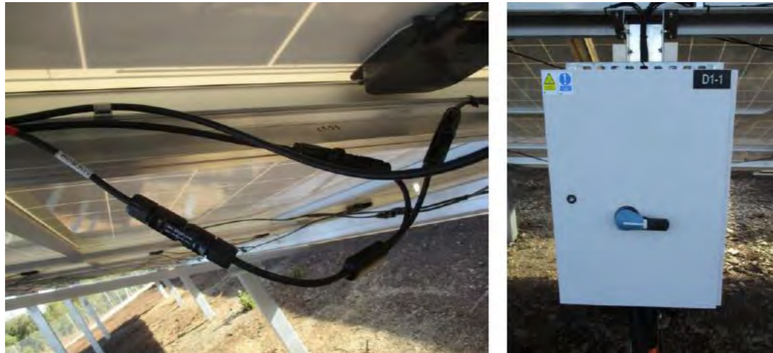
Figure 25 : Exemple de câble électrique et de boîte de raccordement (Source : RES)
