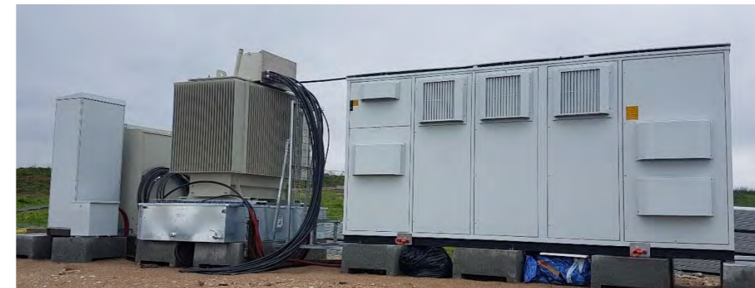
Exemple d'onduleurs et transformateur installés à l'extérieur
